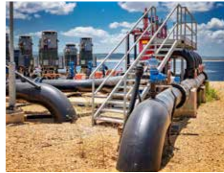
Reningsanläggning vid Shomrat-reservoaren. Foto: KKL-JNF
